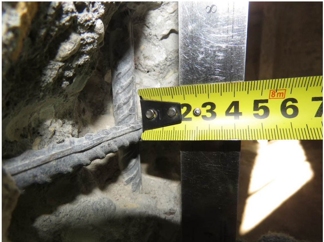
Рис. 3.2.4. Замер толщины защитного слоя монолитной ж.б. стены по оси 7 между осями Б/2-В/2 на отм. -3,300 м
