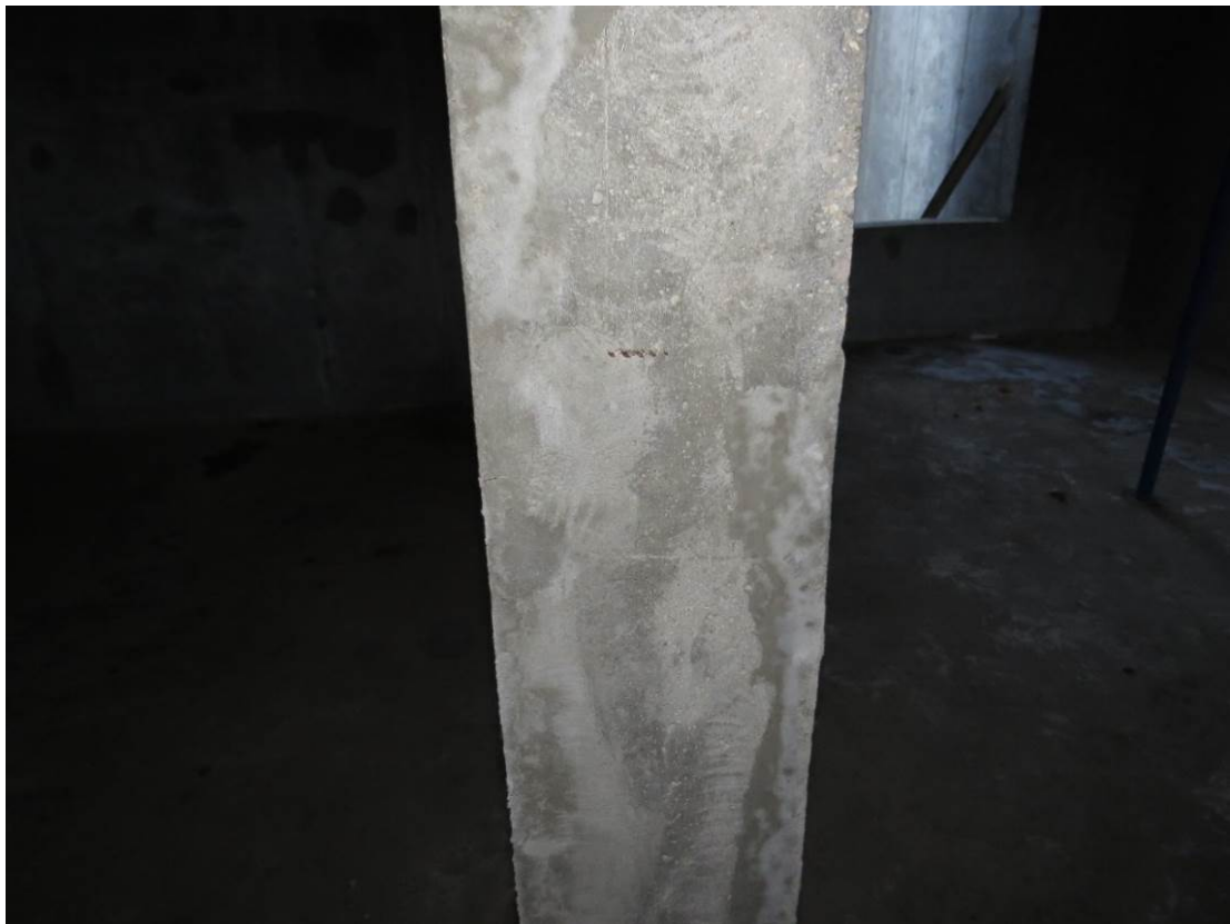
Рис. 3.2.6. Отсутствие защитного слоя бетона с поражением коррозией арматурных стержней пилона по оси 8 между осями А/1-Б/1
