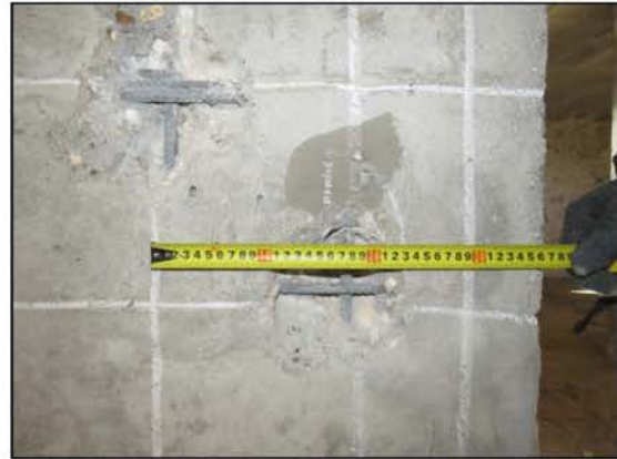
ФОТО 6. Уточнение шага рабочей арматуры монолитного ж/б пилона подвала по оси «7» между осями «Б/2» и «В/2».
