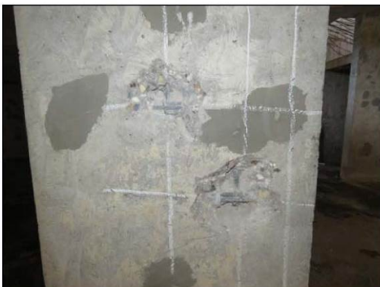
ФОТО 3. Общий вид вскрытия монолитного железобетонного пилона расположенного по оси «6» между осями «В/2» и «В/2».
