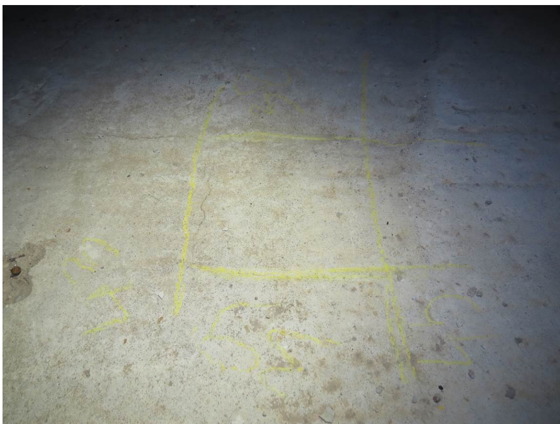
Рис. 3.3.8. Общий вид трещин на верхней поверхности плиты перекрытия подвала шириной раскрытия до 0,2 мм
