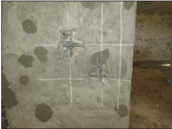
ФОТО 5. Общий вид вскрытия монолитного ж/б пилона подвала по оси «7» между осями «Б/2» и «В/2».
