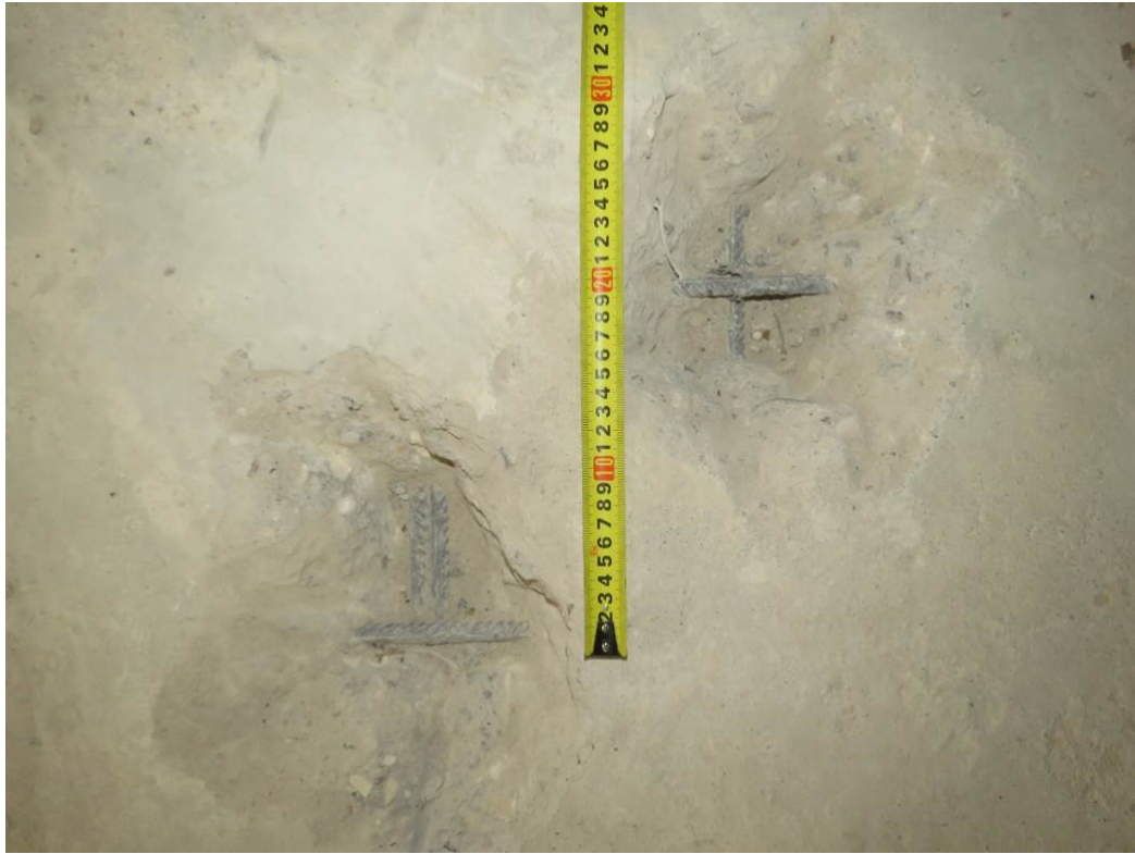
Рис. 3.1.5. Замер шага (200 мм) вдоль буквенных осей верхней зоны армирования фундаментной плиты между секцией 4 и 5 между осями В2-Г2, 7-8
