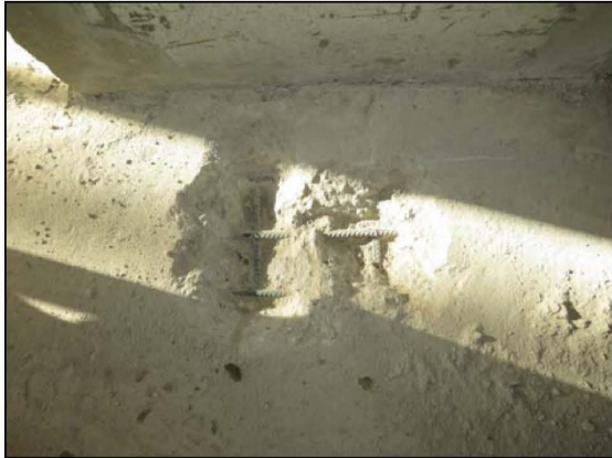
ФОТО 13. Общий вид вскрытия напольной поверхности железобетонной плиты перекрытия подвала между осями «Б/2»-«В/2» и «7»-«8».
