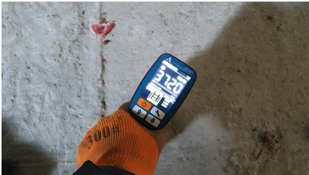
Рис. 4.3.1. Определение прочности бетона в монолитной железобетонной фундаментной плите ультразвуковым методом прибором UK 1401
