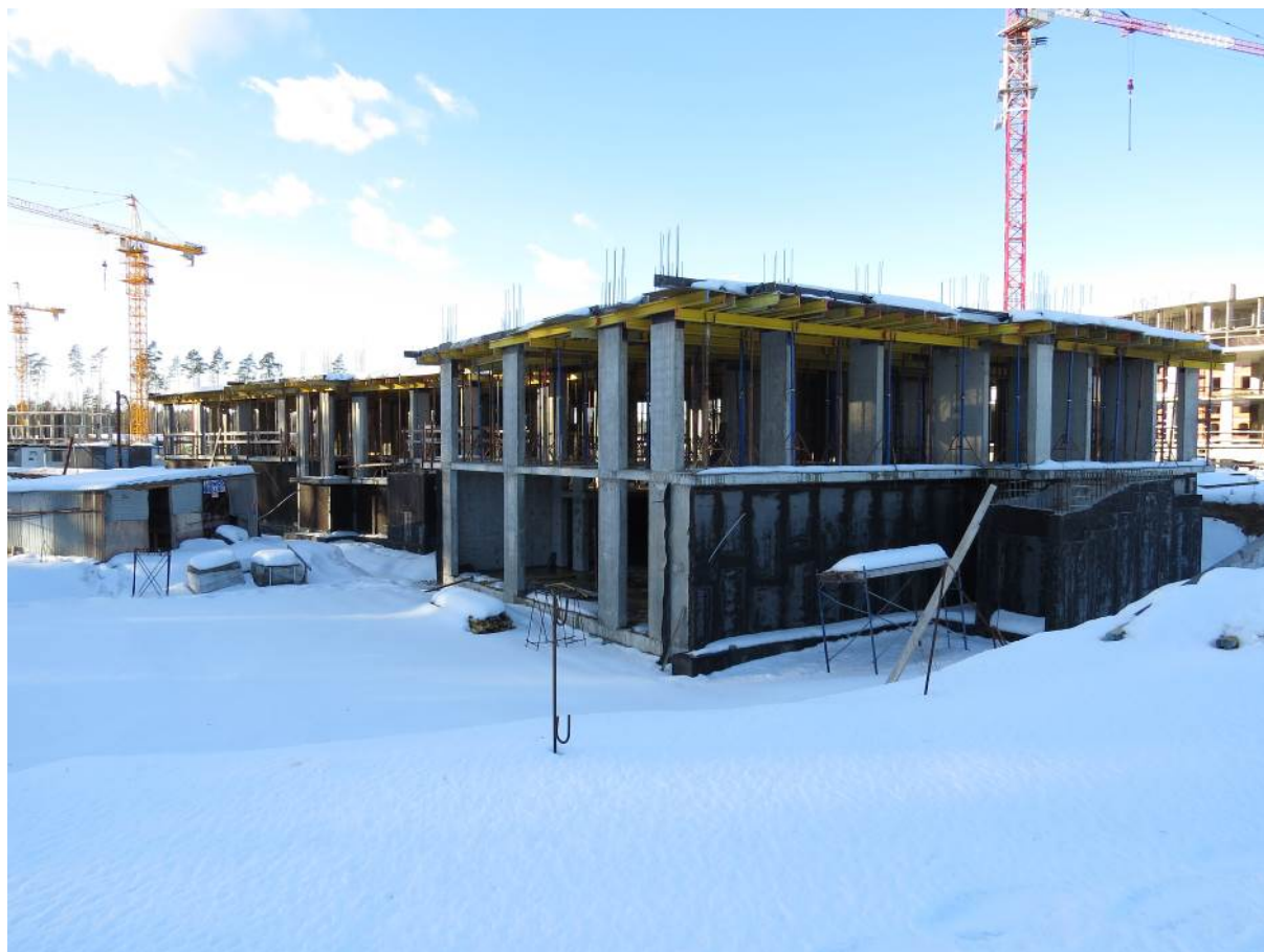
Рис. 3.4.1. Общий вид смонтированных конструкций здания. Отсутствие ограждающих конструкций в виде наружных и внутренних несущих стен
