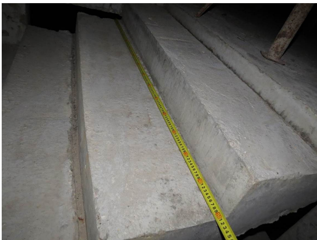
Рис. 3.5.2. Уточнение ширины марша смонтированной лестницы между осями Б/2-В/2 по оси 5
