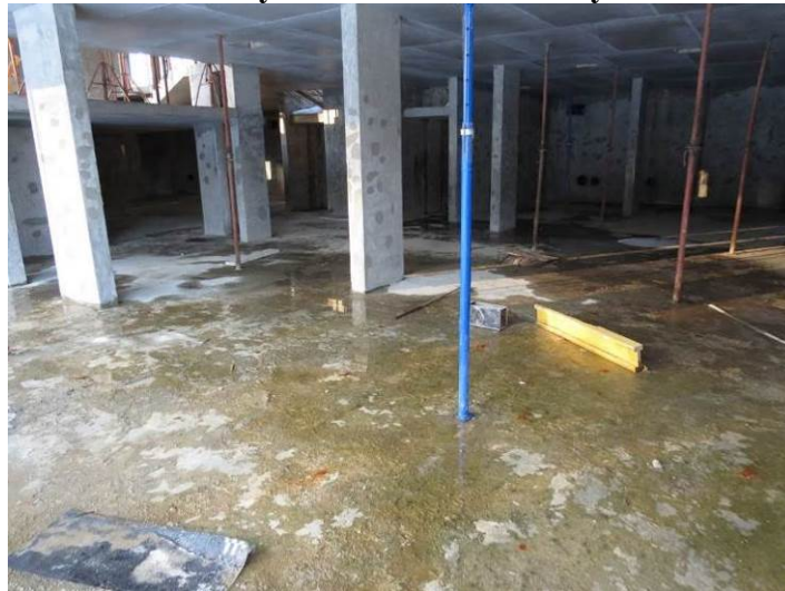
Рис. 3.1.8. Замачивание верхней поверхности фундаментной плиты с последующим замерзанием и фазового перехода воды в лед на высоту до 20 мм
