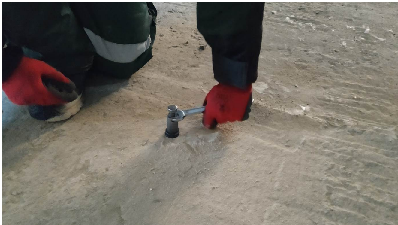
Рис. 4.2.3. Установка анкерного устройства и тяги в отверстии монолитной железобетонной фундаментной плите в осях 3-4/Б/2-А/2
