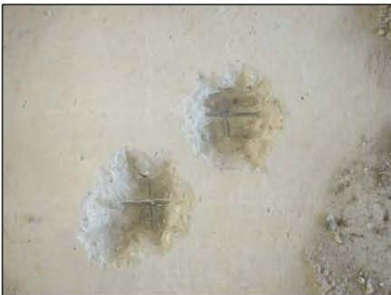
ФОТО 11. Общий вид вскрытия напольной поверхности плиты перекрытия подвала расположенной между осями «В/2»-«Г/2» и «7»-«8».
