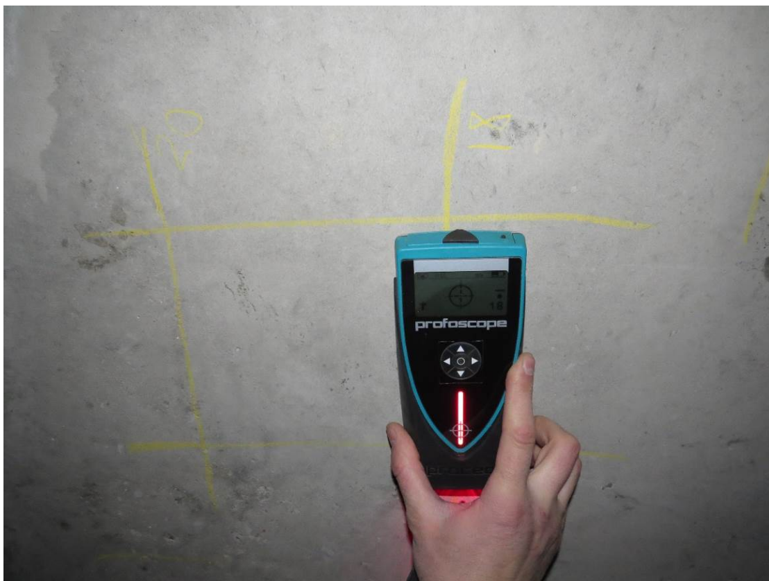
Рис. 3.3.7. Определение положения рабочей арматуры и толщины защитного слоя бетона в монолитной ж.б. плите перекрытия магнитным методом прибором «Profoscope»
