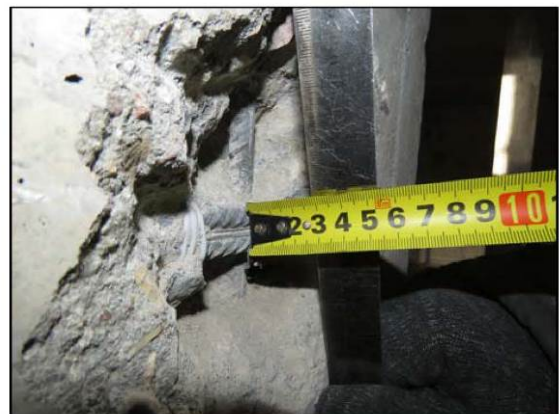
ФОТО 4. Уточнение защитного слоя бетона монолитного железобетонного пилона расположенного по оси «6» между осями «В/2» и «В/2».
