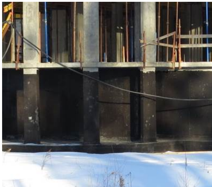
Рис. 3.1.9. Отсутствие дренажной мембраны типа «Дренаж» на монолитной железобетонной фундаментной плите, наблюдается по всему периметру здания
