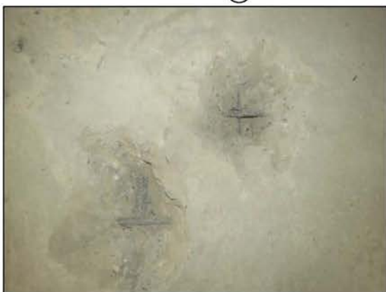
ФОТО 7. Общий вид вскрытия поверхности пола монолитной железобетонной фундаментной плиты расположенной по оси «В/2» между осями «7»-«8».
